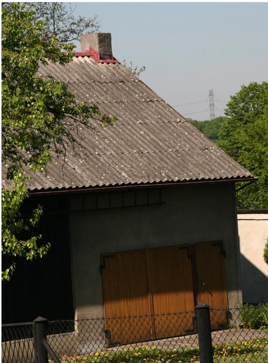
Rysunek 3 Dach pokryty płytami azbestowymi falistymi
